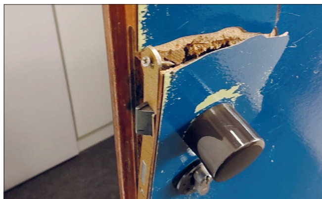
Die eingetretene Tür des Vereinsbüros in der Eishalle in Timmendorfer Strand. (Foto: hfr)
