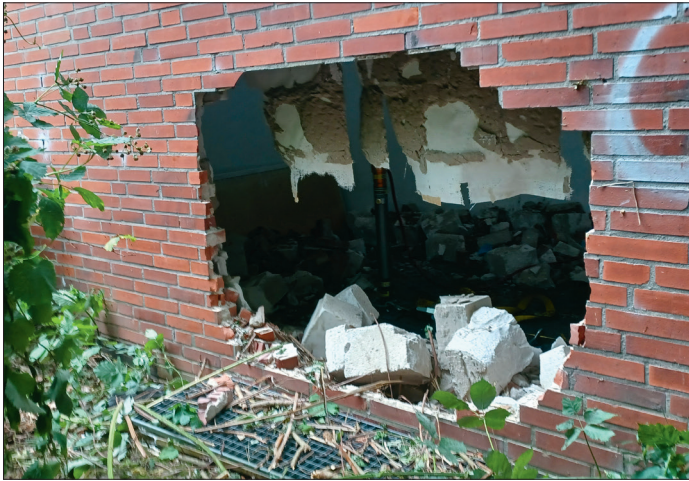
Das Fahrzeug hat die Wand des ehemaligen Wartezimmers durchbrochen und ist dort stecken geblieben.
