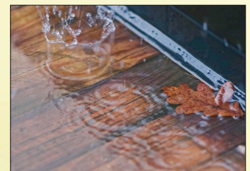
Bei Starkregen kann es zu Stauwasser auf dem Balkon kommen. Werkfoto: Triflex
