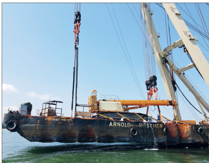
Deutschlands größter Schwimmkran „Enak“ birgt den havarierten Ponton an der Seebrücken-Baustelle in Timmendorfer Strand.
