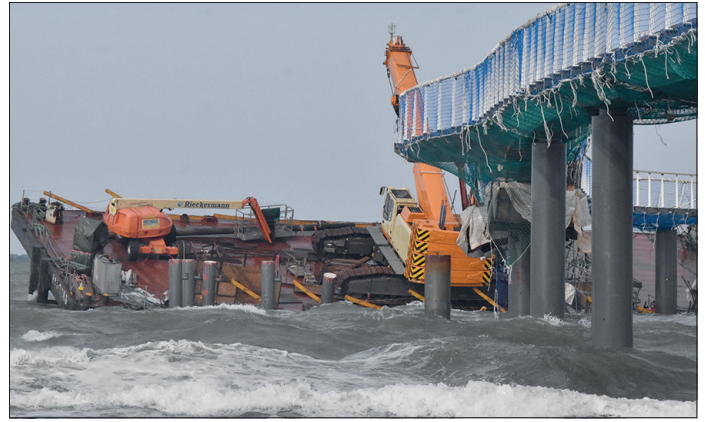
Am Dienstag, 21. Mai, hat sich an der Baustelle der neuen Maritim-Seebücke der Arbeitsponton mit Kran losgerissen und schlug gegen die Brückenkonstruktion. (Foto: René Kleinschmidt)
