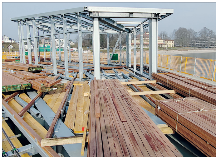
Das Stahlgerüst für den Wetterschutz, in dem ab Sommer auch Trauungen in Haffkrug stattfinden, steht bereits. Davor lagert das harte Bongossi-Holz, das als Bodenbelag verbaut wird.
