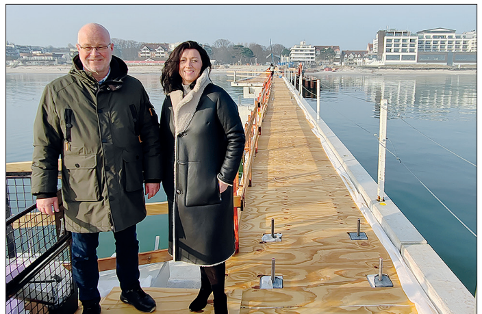
Dipl.-Ingenieur Andreas Geist vom Bauamt der Gemeinde Scharbeutz und Bürgermeisterin Bettina Schäfer auf der Scharbeutzer Seebrücke. Noch liegt hier ein provisorischer Bodenbelag. Links fehlt noch der im Text genannte Balkon (Seitenausleger).
