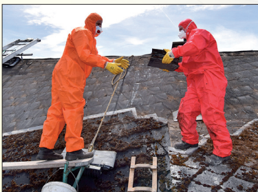
Wer eine alte Immobilie saniert, muss sich gegen böse Überraschungen wappnen. Werkfoto: Rathschek Schiefer/BHW
