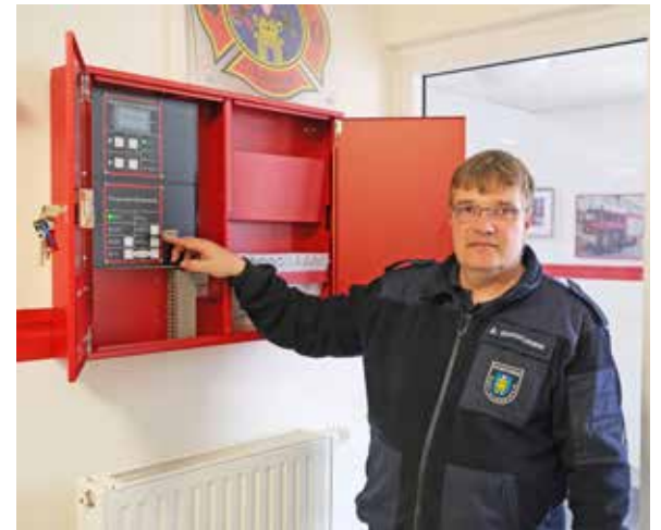
Oldenburgs Wehrführer André Hasselmann steht an der neuen Brandmeldeanlage im Feuerwehrhaus.
