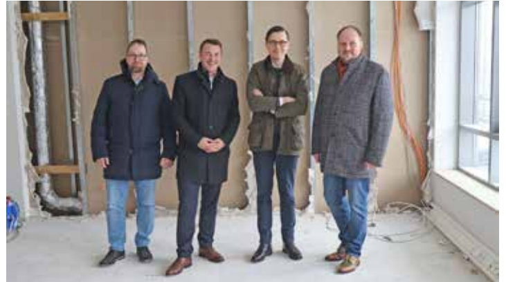
Dr. Markus Flügel, Franz Loose, Stephan Freitag und Landrat Timo Gaarz besichtigen die Baustelle am Klinikstandort Eutin. Foto: © Kreis Ostholstein
