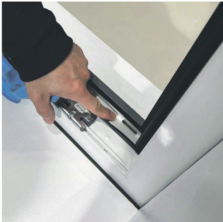
Die Wasserschlitze im Blendrahmen sollten ebenfalls auf Verschmutzung geprüft und bestenfalls regelmäßig gereinigt werden, so dass Niederschlagswasser aus der Falzluft ungehindert ablaufen kann. Fotos: TMP/hfr
