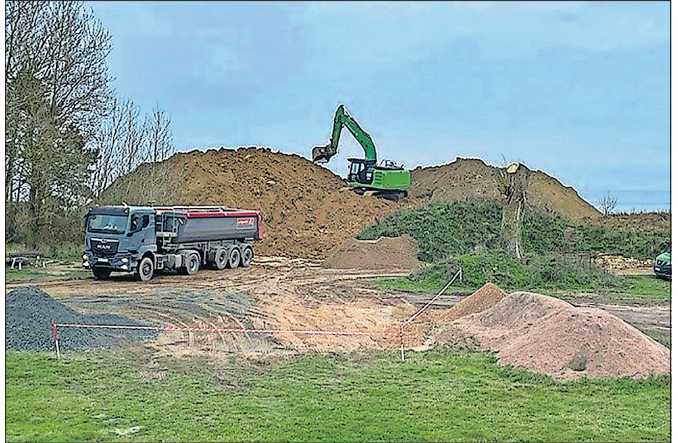
Das Material wird von Baustellen aus der Region angeliefert, beispielsweise von den Erdarbeiten bei der Aufstellung von Windrädern.
