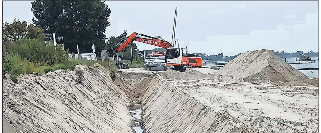
Mindestens drei Meter tief wird der Graben, in dem die Steinvorlage die Mauer als Widerlager zukünftig schützen soll.
