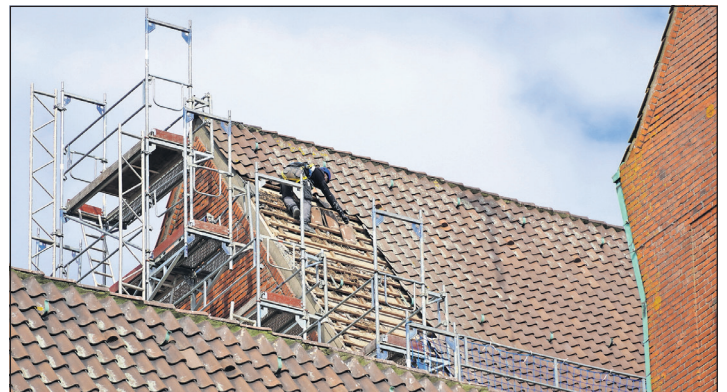
Die Dächer des Speichers sind marode, werden abgerissen und später wieder aufgebaut.
