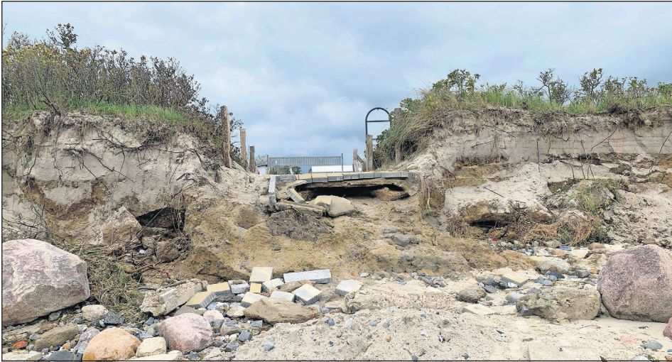
Besonders gefährdet ist die Küste in Pelzerhaken. Im Oktober entstanden hier bei der Sturmflut schwere Schäden.
