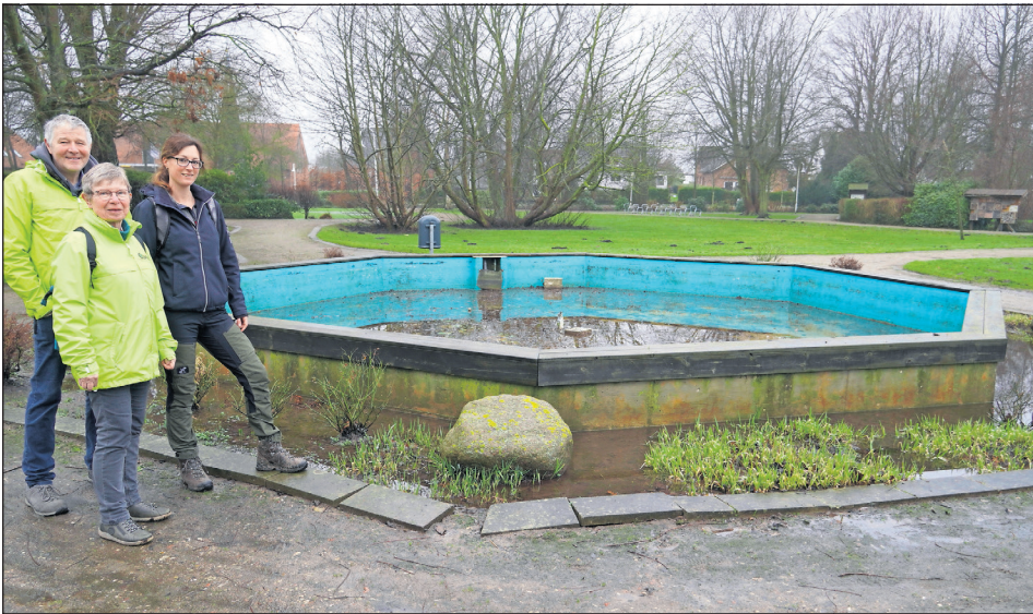
Der Brunnen im Kurpark ist in die Jahre gekommen und äußerst marode. Er soll zu einem Paradies für Amphibien umgestaltet werden. Sämtliche Maßnahmen werden von Axel Kramer und Irene Timmermann-Trosiener aus dem BUND-Kreisvorstand sowie Bürgermeisterin Stefanie Friedrich-Suhr (v. lks.) begleitet.
