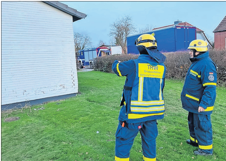
Das THW begutachtete den Schaden und leitete die Abstützmaßnahmen ein. (Fotos: THW Neustadt)
