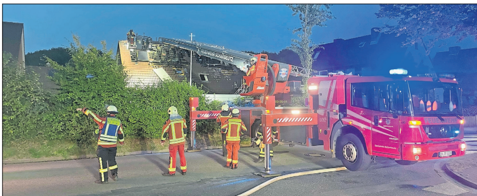
Die Einsatzkräfte der Freiwilligen Feuerwehr Neustadt öffneten das Dach über mehrere Seiten, um das Feuer zu bekämpfen.
