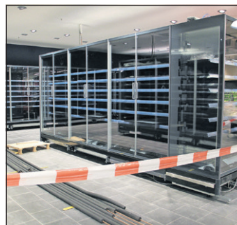
Aufbaustimmung im Molkerei-Kühl-Bereich: Ende Juli soll hier alles fertig sein.
