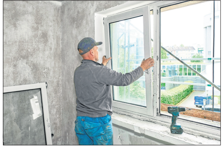
Alte Kunststoffenster werden ausgebaut und durch Modelle mit Recycling-Anteilen ersetzt. Foto: djd/REHAU AG + Co
