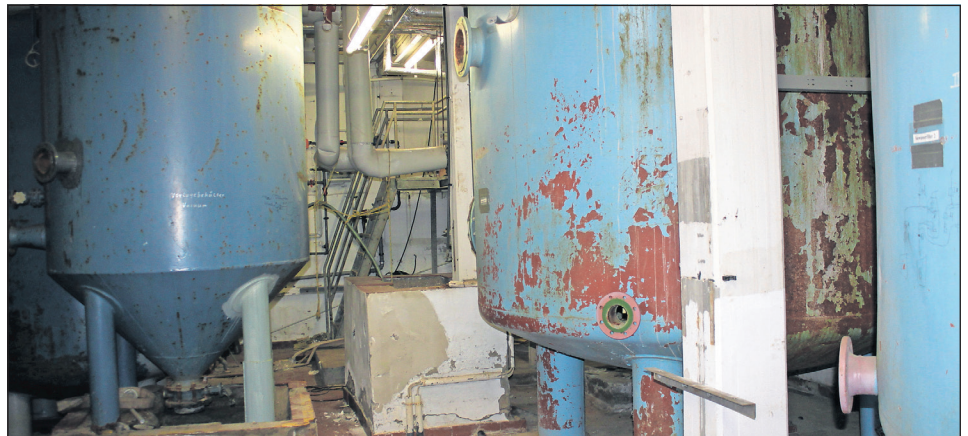
Der Raum unter dem Schwimmbad ist vollkommen marode, die Technik überaltert.
