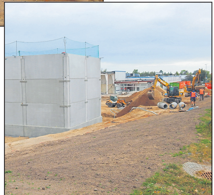
Blickrichtung Ortmühle-der Neubau schreitet voran und der Abriss ist in vollem Gange
