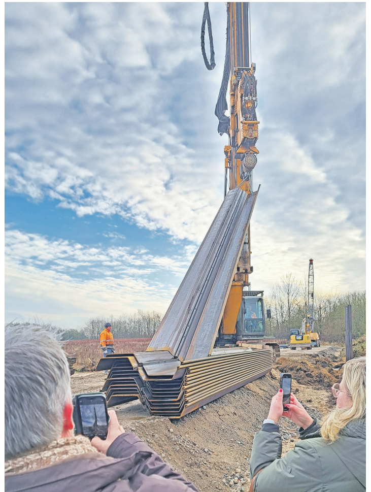
An der Straßenböschung wird zurzeit eine Spundwand in den Boden gerammt. Fotos: Graap
