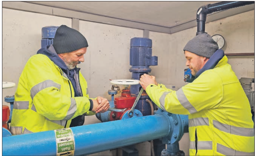
Monteur Andreas Linke (links) und Vorarbeiter Tobias Wodi an der Technik beim Hochbehälter.
