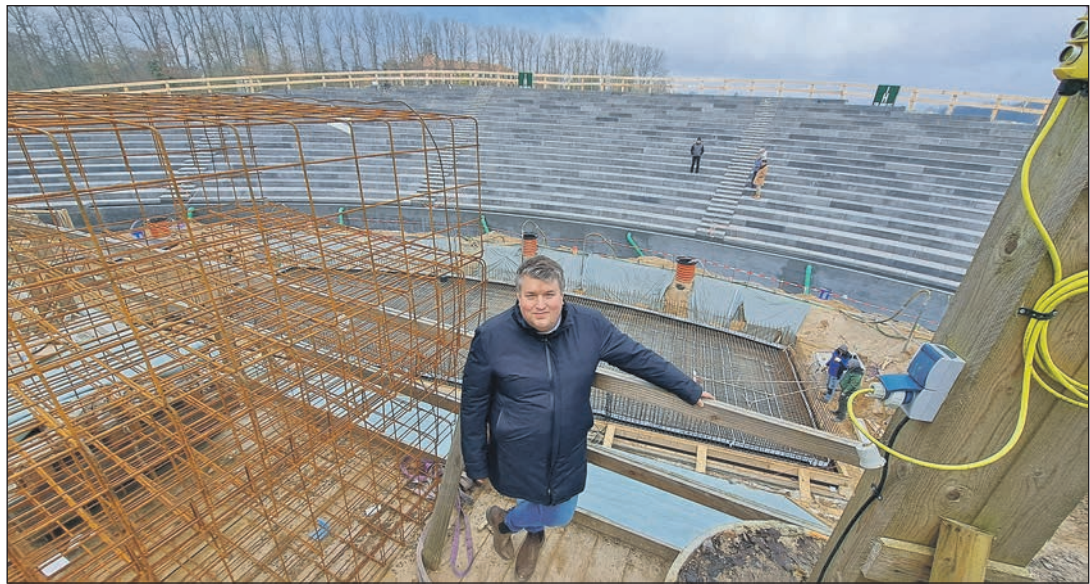
Festspiel-Geschäftsführer Falk Herzog weiß, dass der Bauzeitplan für den Tribünen-Neubau sehr sportlich ist. Der Orchestergraben (im Hintergrund) wird in diesen Tagen hergestellt. Foto: Graap
