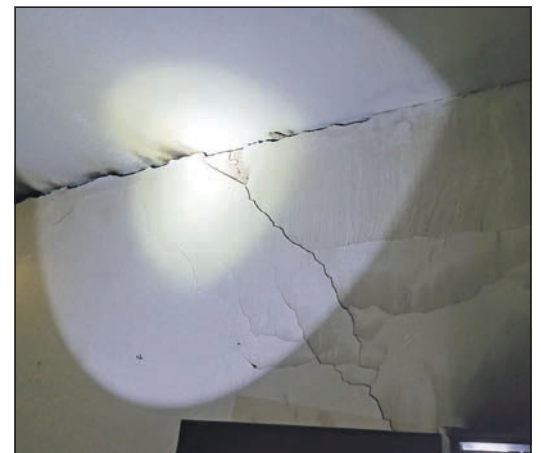
Risse: Die Statik wird derzeit geprüft. Foto: hfr
