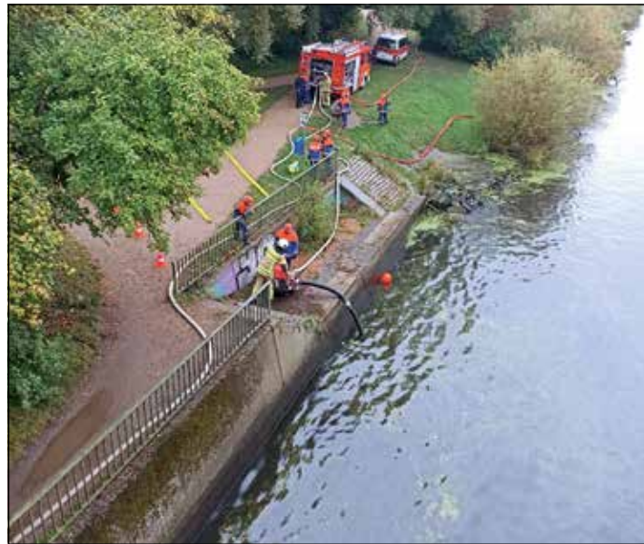
Die Schlauchleitung führte entlang des Elbe-Lübeck-Kanals (Fotos LVF).
